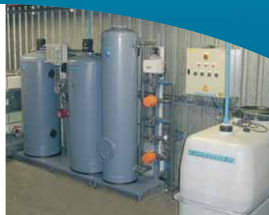
Wasserkreislauf über Mehrschichtfilter und Entsalzungsanlage in einer Phosphatierungsline bei einem Hersteller von Metallmöbeln.
