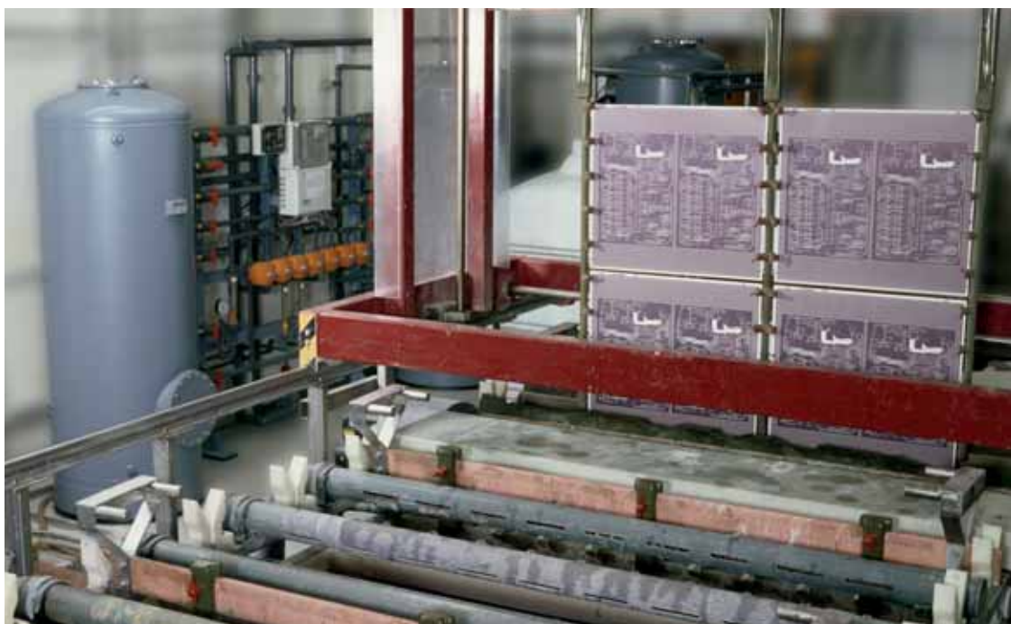
Schwermetall- Restentfernung durch Mehrschichtfilter und Selektivaustauscher bei einem Hersteller von Mikroelektronik.
