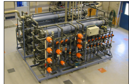
Schwedische Trinkwasseraufbereitungsanlage für 48 m³/h. Die Anlage umfasst 2 Nanofiltrationsanlagen Typ NF 03-24, Vorfilter und eine vollautomatische Reinigungsanlage. Anwendung: Enthärtung von Grundwasser.
