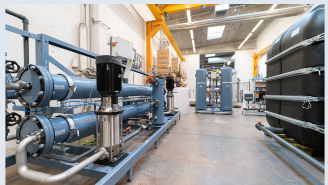
POWER-TO-X | GRØNN HYDROGEN Vannbehandling for elektrolyser
