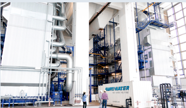
MOBIL VANNBEHANDLING Utleie | Kort og lang sikt
